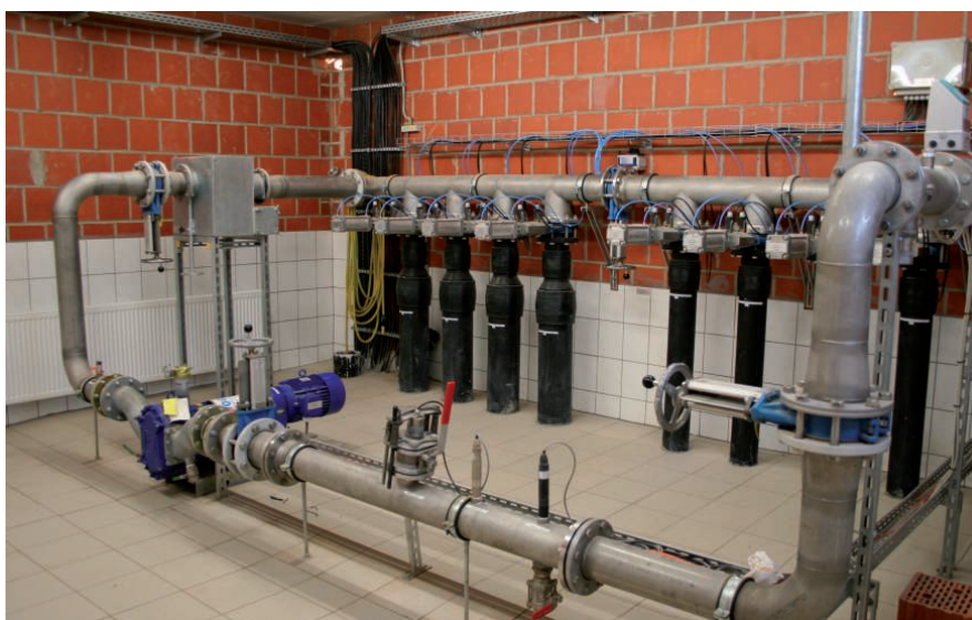
Fig. 3 : station de pompage centrale de l'installation de biogaz de Lebach avec capteurs en ligne (à l'avant)
