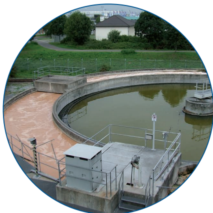
Fig. 1 : Bassin d'oxydation avec décantation secondaire intégrée
